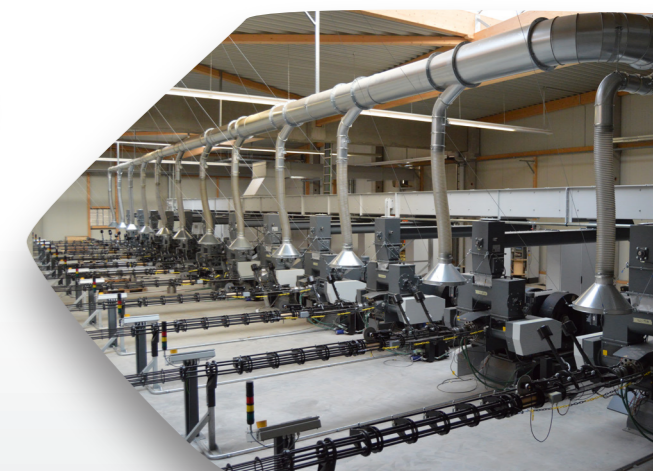
Installation bei Holzindustrie Torgau, Deutschland
